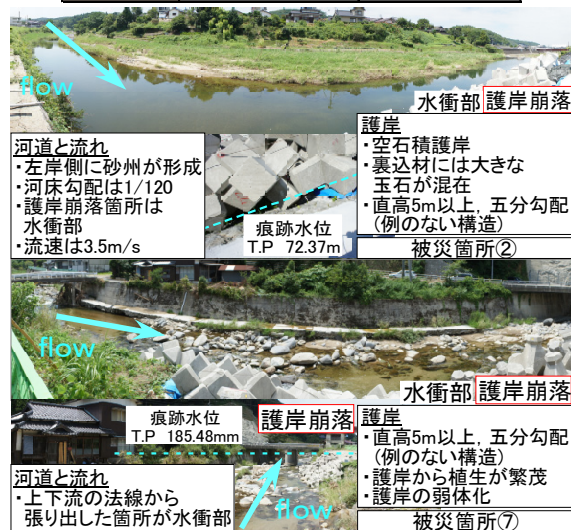
図-6 ②と⑦の被災状況
